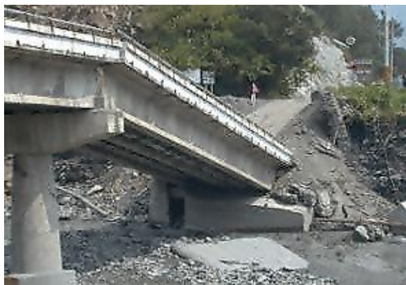
圖 2 十八重溪橋 A2 端陷落
