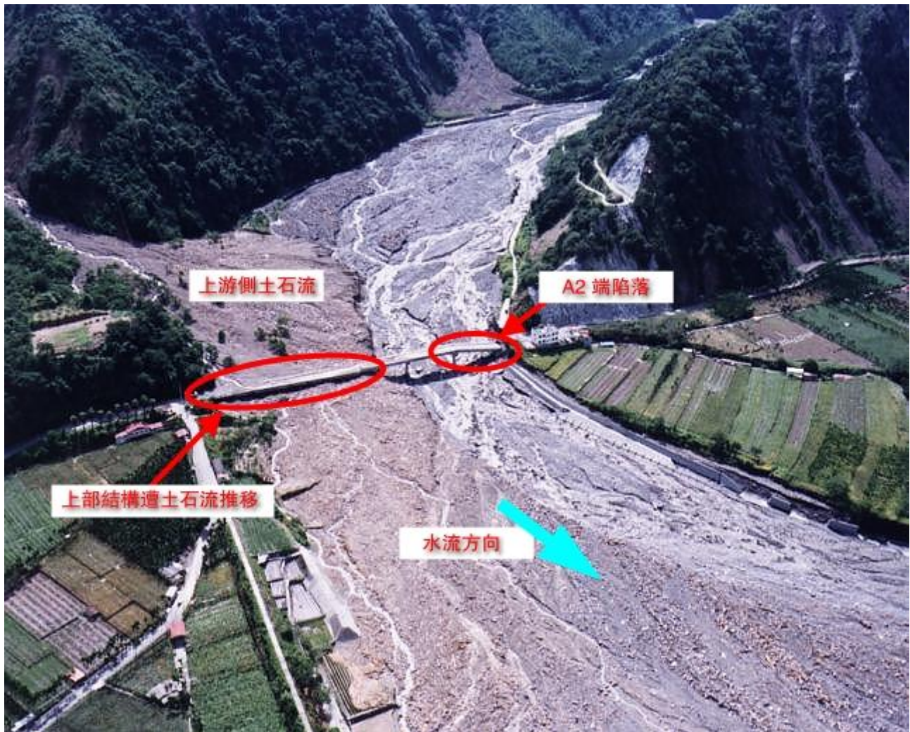
圖 1 十八重溪橋 A1-P3 端上部結構遭土石流推移；A2 橋台損壞下陷，上部結構陷落。 (國立中興大學土木工程學系 林 呈教授 提供)
