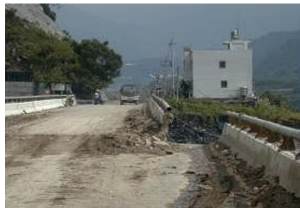
圖 3 十八重溪橋上部結構遭土石流推移
