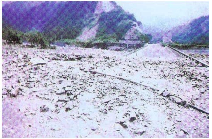
圖四 土石流覆蓋十八重溪橋情形
