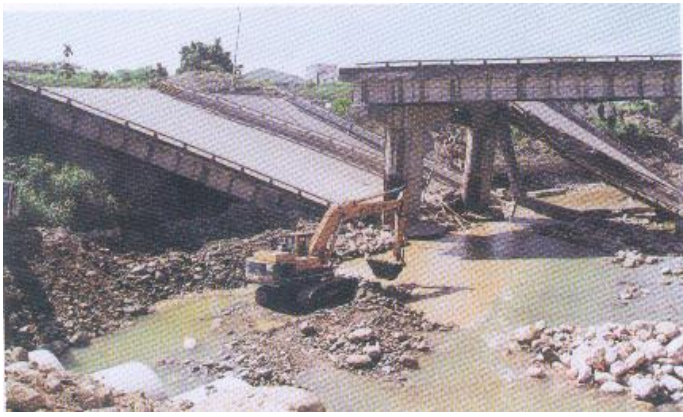
照片 1 石圍橋南端二跨橋面墜落
