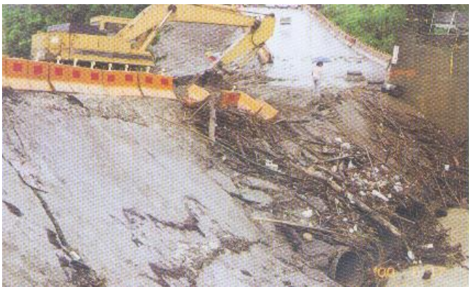
照片 13 第二次潰堤便道損壞情形
