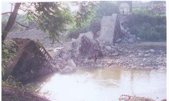
照片 2 石圍橋上游處之玉成橋亦遭震毀
