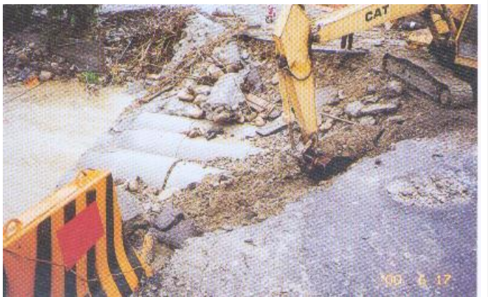
照片 14 第二次潰堤便道損壞情形
